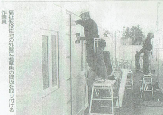
福祉仮設住宅の外壁に苦痛色の鋼板を取り付け作業中。
